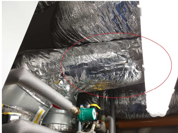
Obrázek 2 – deformované flexibilní potrubí odtahu
