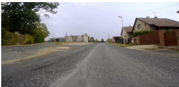
Obrázek 7 - nezpevněný povrch s lehkými poruchami
