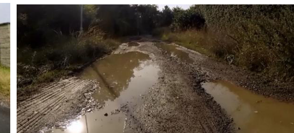
Obrázek 17 - nezpevněný povrch v havarijním stavu
