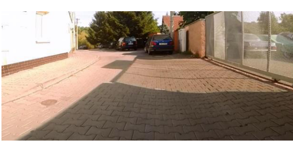
Obrázek 8 - zámková dlažba s lehkými poruchami
