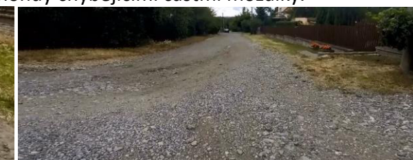
Obrázek 14 - nezpevněný povrch s těžkými poruchami
