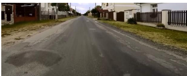
Obrázek 9 - asfaltový povrch se středními poruchami
