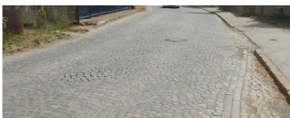
Obrázek 10 - kamenná dlažba se středními poruchami
