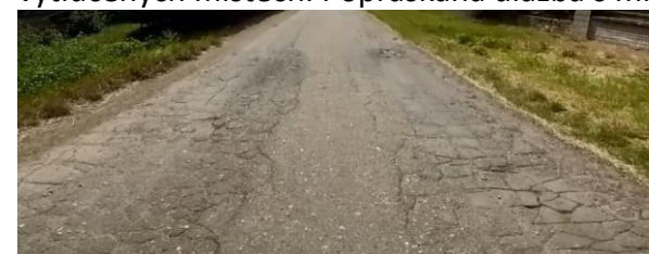
Obrázek 13 - asfaltový povrch s těžkými poruchami
