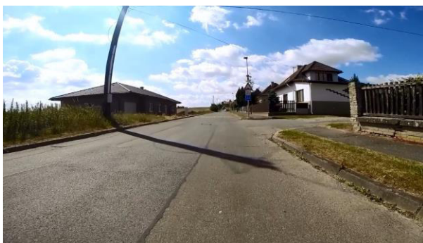
Obrázek 5 - asfaltový povrch s lehkými poruchami
