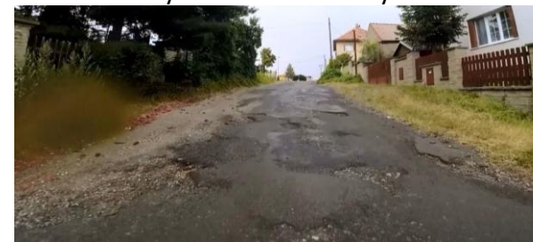
Obrázek 16 - asfaltový poruch v havarijním stavu
