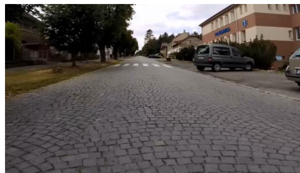
Obrázek 6 – kamenná dlažba s lehkými poruchami
