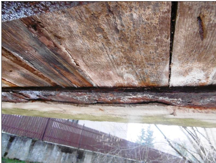
Rovnoměrná, celková koroze, výrazně oslabená dolní pásnice. Ztrouchnivělé fošny původně tvořící ztracené bednění desky.
