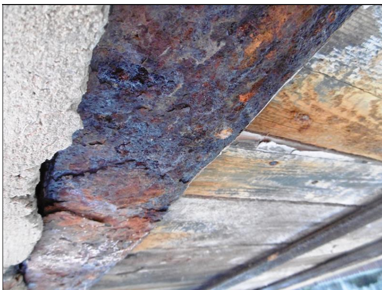
Rovnoměrná, celková koroze, výrazně oslabená dolní pásnice.
