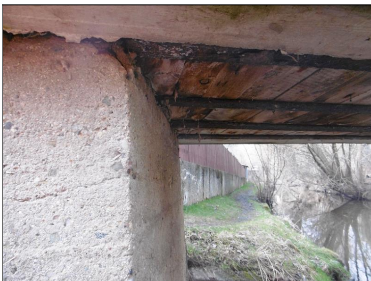
Detail dířku opěry- degradace betonu.
