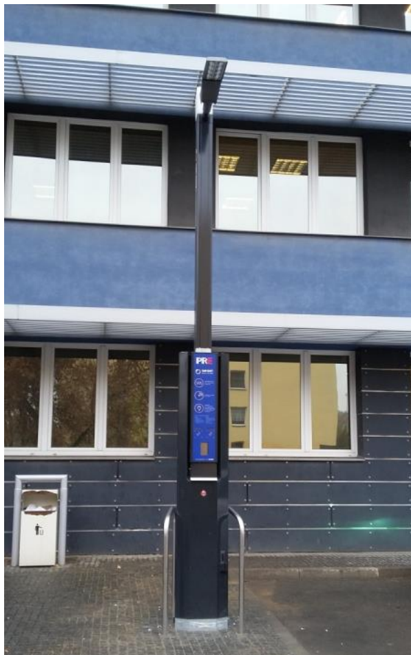
Obrázek 22 Víceúčelové sloupy veřejného osvětlení jsou již v běžné nabídce výrobců, ale jejich prosazení závisí mimo jiné na koncepci integrovaného přístupu v daném městě a v případě integrace dobíjecích stanic také na vývoji tarifního systému (foto: www.allforpower.cz )
