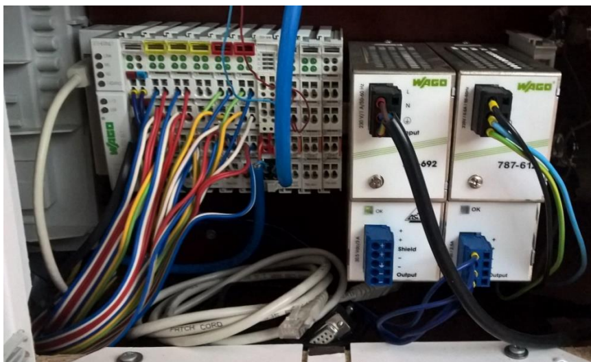
Obrázek 24 Část rozvaděče VO s řídicím systémem WAGO PFC200 Controller (foto: vlastní)
