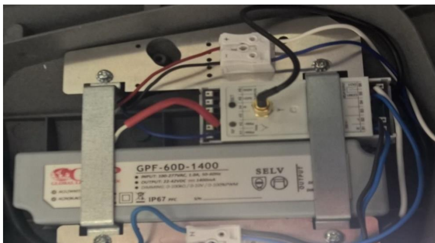
Obrázek 25 Elektrická výzbroj LED svítidla veřejného osvětlení, které je vybaveno regulovatelným driverem a přijímačem Wi-Fi. Volitelně lze vybavit senzorem přítomnosti nebo bezdrátovou kamerou včetně akumulátoru (foto: vlastní)
