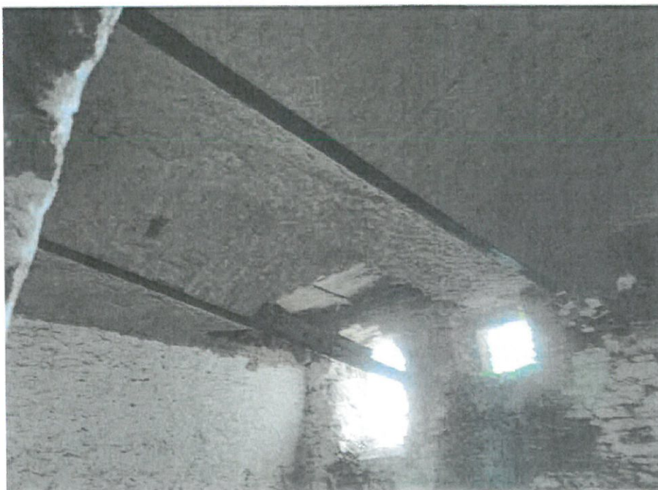
Opět pravděpodobný pokus o demolici od vandalů.
