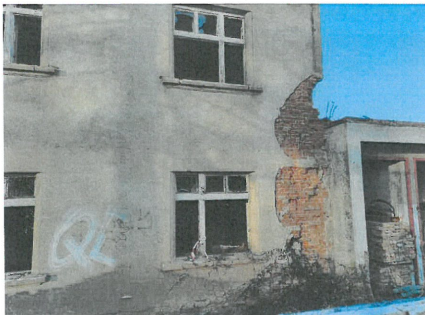
6- na snímku je patrná degradace zdiva
