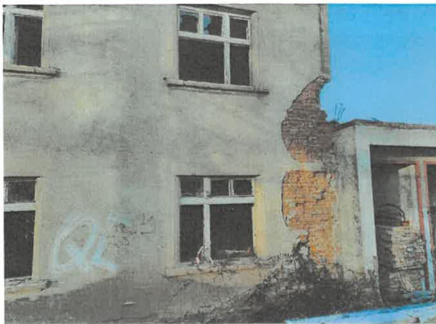
6- na snímku je patrná degradace zdiva
