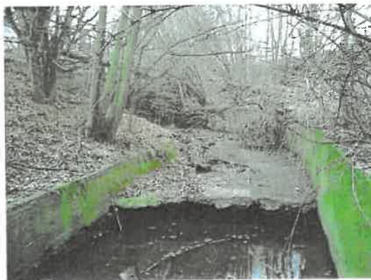
Pohled na havarijní stav skluzu (leden 2008)
